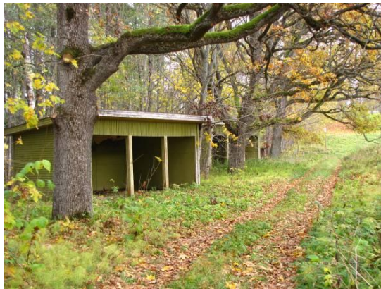
Foto 9. Rüütlimäele suunduva tee äärde tammede vahele on ehitatud kaks kioskit, mille katused on osaliselt sissevajunud, 2011.
